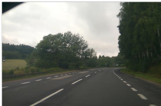
Fot. 16. Fragment odcinka za Jelenią Górą – szerokie pobocze i wypełnione ubytki
