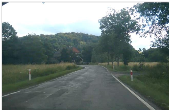
Fot. 21. Fragment analizowanej drogi o bardzo złym stanie technicznym
