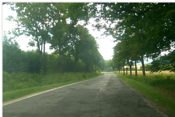
Fot. 22. Liczne ubytki w nawierzchni analizowanego odcinka
