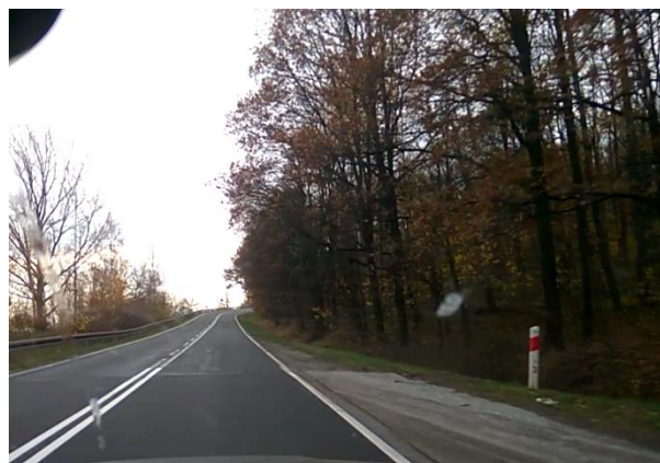
Fot. 3. Stan DK nr 34 na odcinku 2 do 5 km
