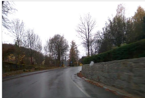
Fot. 32. Stan DW nr 375 w Chwaliszowie
