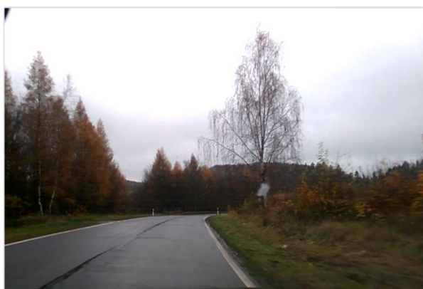
Fot. 29. Stan DW nr 375 w rejonie km ok. 003+000
