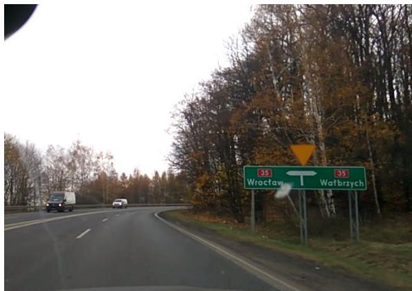
Fot. 10. Stan nawierzchni w rejonie zjazdu na DK nr 35
