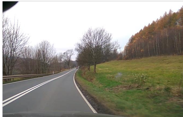
Fot. 42. Stan DW nr 367 w rejonie km ok 052+750
