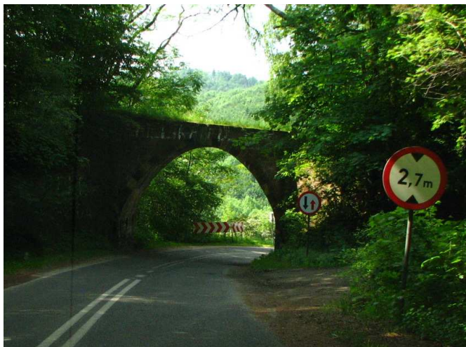
Fot. 7.10 Brak skrajni pionowej na odcinku drogi wojewódzkiej nr 385.
