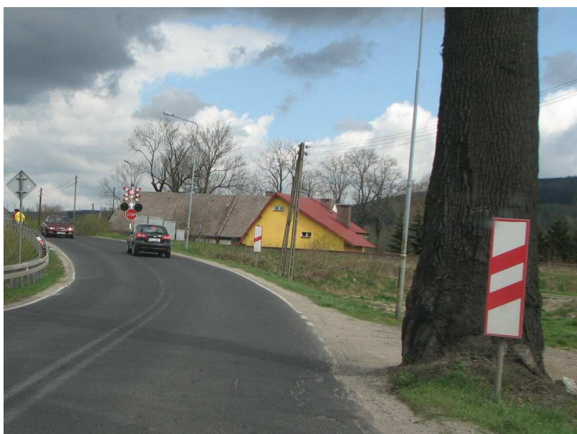
Fot. 7.9 Odcinek drogi krajowej nr 5 w miejscowości Dębrznik. Zdjęcie przedstawia brak widoczności na dojeździe do skrzyżowania z linią kolejową i brak skrajni poziomej.
